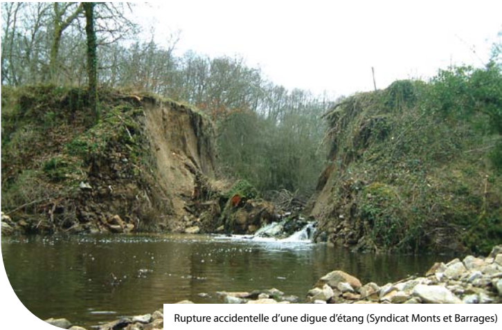
Rupture accidentelle d'une digue d'étang (Syndicat Monts et Barrages)
